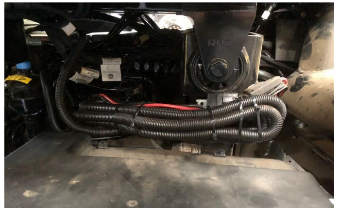
Figura 4 – Fijación sobre la caja de batería
