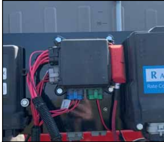
FIGURE 13. ET Apache Center Rack Power Module
