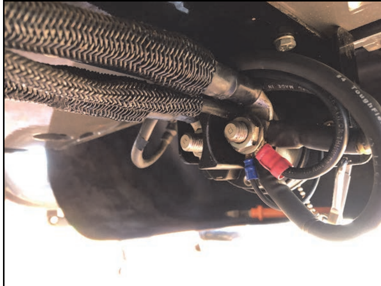
FIGURA 2. Cables GND del Chasis y de Hawkeye Conectados a la Llave General
