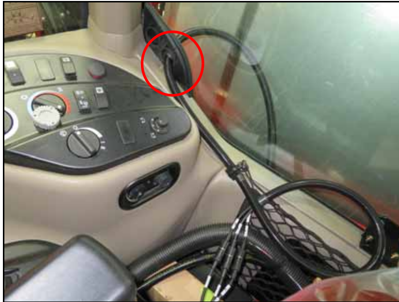
ABBILDUNG 12. Kabeldurchführung in das Fahrerhaus
