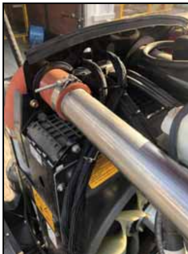
Passagem acima do Radiador
