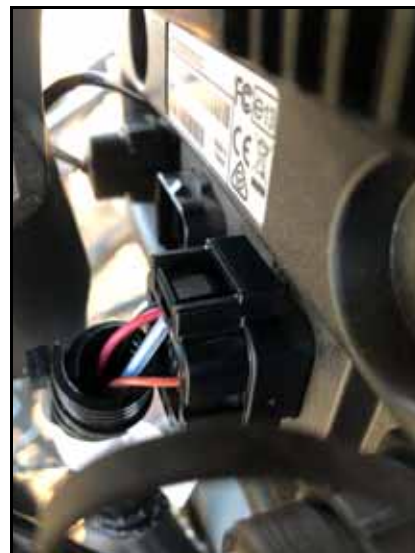
Conexão no C3000
