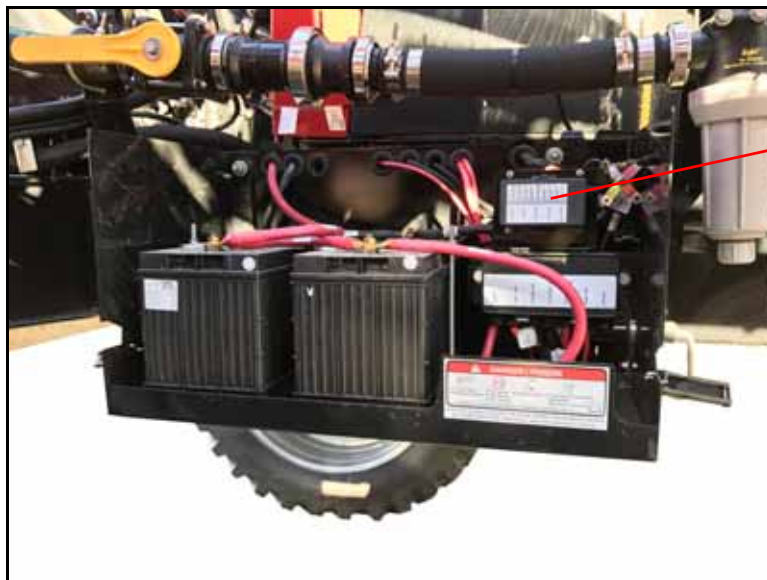
FIGURA 4. Painel de fusíveis
