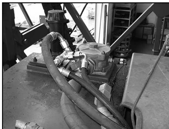
FIGURA 10. Mangueiras do Tanque Instalado
