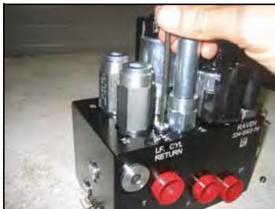
FIGUUR 17. Poortplug opnieuw op de AutoBoom-klep gemonteerd
