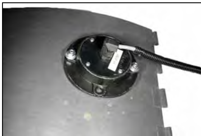
Рис. 3. Пример монтажа датчика влажности
